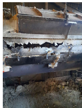
↑ 長年の使用で腐食が進み穴が開いてしまった攪拌機
