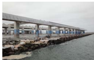
修復工事がストップしている相馬松川浦漁港
